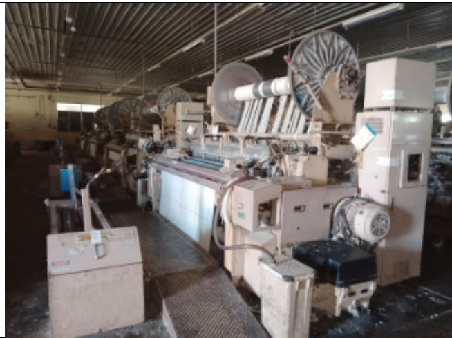
Máy móc thiết bị - Công Ty Cổ Phần Dệt Gia Dụng Phong Phú/ Machines, equipment - Phong Phu Home Textile Joint Stock Company
